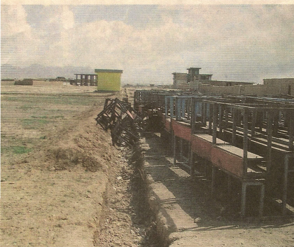
Mauern fehlen, Bänke stehen im Freien. Laila Noor und der Verein Independent Afghan Women Association wollen eine zweite Schule bei Kabul mit Spenden zu Ende bauen.
